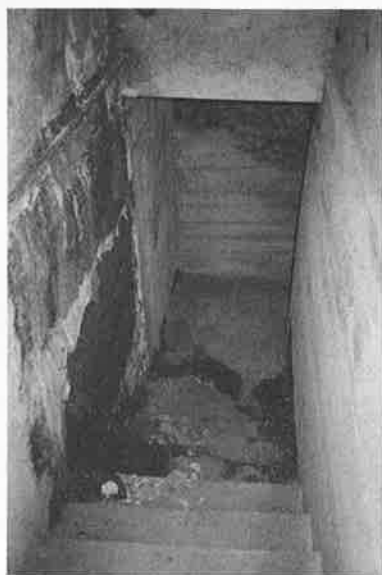
Stiegenabgang in den Keller – den künftigen Heizungsraum – Teile des Hausfundamentes fehlen. Foto: Josef Schmidt
