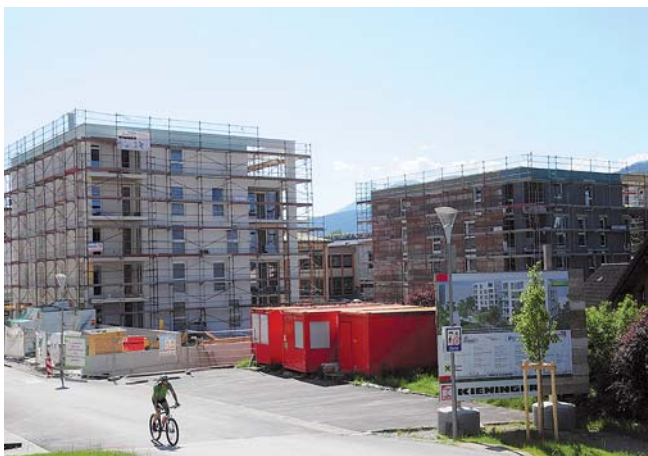
Weiters wird Schritt für Schritt auch bereits mit den Fassadenarbeiten begonnen. Die Fertigstellung ist für den Dezember dieses Jahres geplant.
