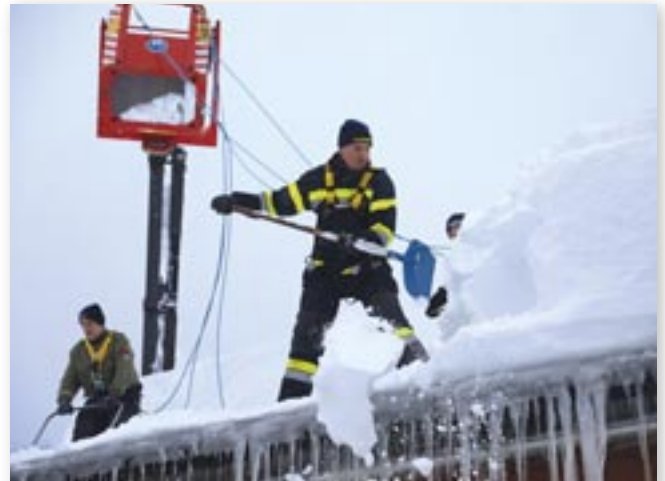
Zahlreiche Dächer mussten abgeschaufelt werden.
