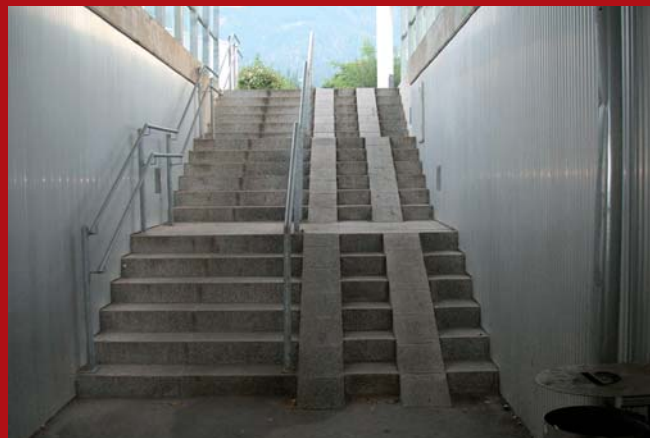
Die nicht barrierefreie Unterführung bei der B320 Ennstalstraße wird bald der Vergangenheit angehören.
