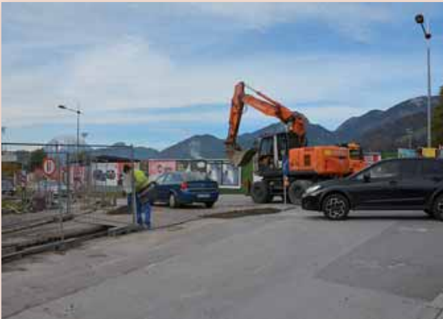
Bauarbeiten für Nahwärmenetz: Die Verkehrsteilnehmer wurden in diesem Herbst auf so manche unangenehme Probe gestellt.
