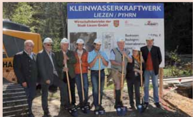
Im Mai 2012 erfolgt der Spatenstich für die Errichtung des gemeindeeigenen Kleinwasserkraftwerks im Pyhrn.
