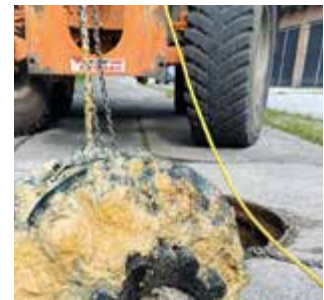
Die Pumpstation in der Admonter Straße muss regelmäßig gereinigt werden. Auch auf diesem Bild ist die starke Verunreinigung durch Altöl und Feuchttücher nicht zu übersehen.
